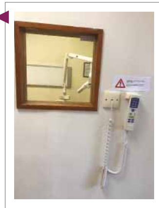
图 21. 示工作人员可从防辐玻璃窗观察受检者。防辐玻璃吸收了杂散辐射。
